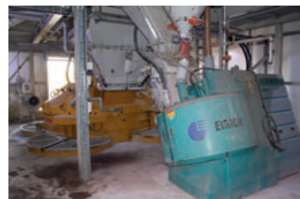
Um misturador Haarup e um misturador Eirich alimentam a máquina de blocos de concreto com concreto arquitetônico e de núcleo.
