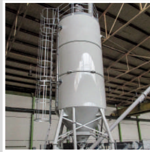
Silosy cementu, popiołów, mączki kamiennej
